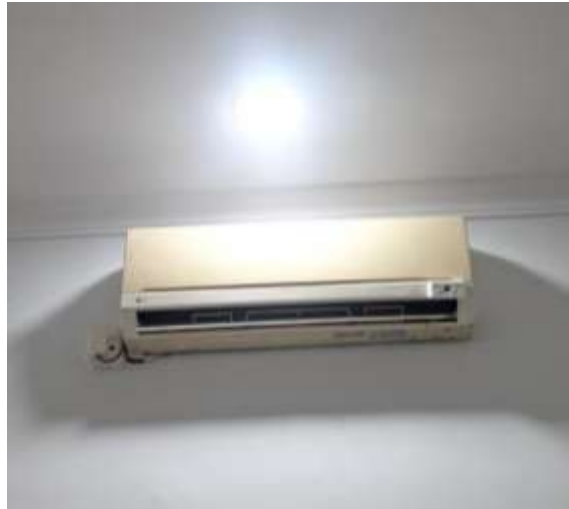
Gambar 4.9: Pendingin Ruangan (AC) Yang Ada di Ruang Arsip Kantor Kementerian Agama Kota Malang.
