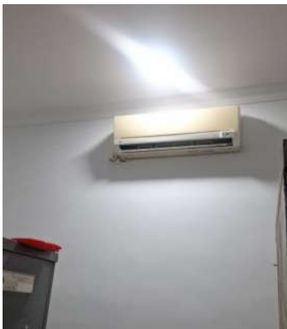
Gambar 4.25: Gambar Pendingin Ruangan Yang Ada di Ruang Arsip Kantor Kementerian Agama Kota Malang. (Sumber: Dokumentasi Peneliti, 2026)
