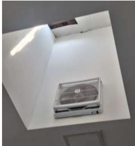
Gambar 4. 21: Gambar Exhaust Fan Yang Di Miliki Di Ruang Arsip Kantor Kementerian Agama Kota Malang. (Sumber: Dokumentasi Peneliti, 2026)
