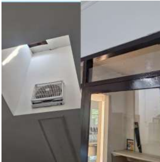
Gambar 4. 8: Gambar Exhaust dan Ventilasi Udara di Ruang Arsip Kantor Kementerian Agama Kota Malang (Sumber: Dokumentasi Peneliti, 2026)
