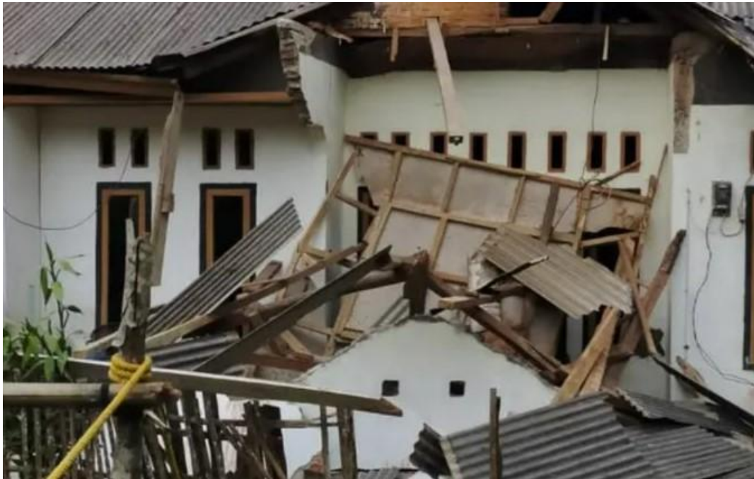
Gambar 2. 1 Contoh bangunan rusak pascabencana alam
