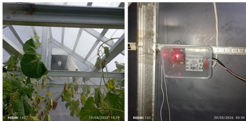
Gambar 4. 4 Implementasi Aktuator Exhaust Fan
