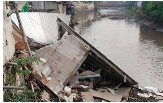
Gambar 3: Bangunan yang ambruk ke sungai [7]
