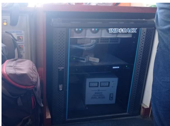
Gambar 4.23 Mini Server dan UPS (Dokumentasi Pribadi)
