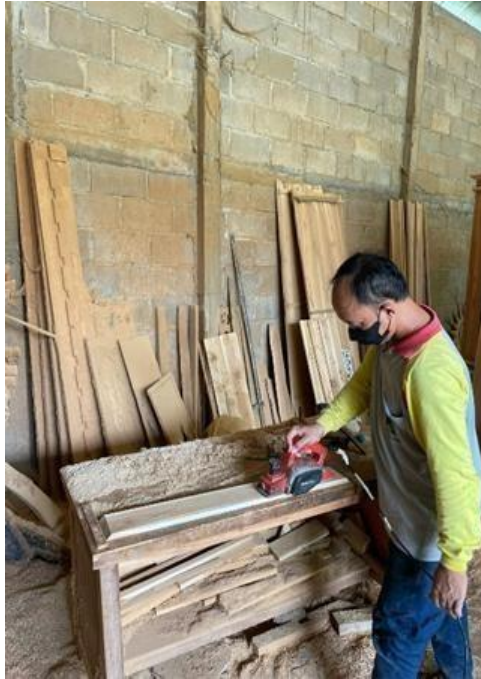
Gambar 3. Penggunaan alat yang tidak layak untuk digunakan (terdapat lilitan isolasi pada kabel alat yang digunakan )
