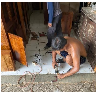
Gambar 6. Bukti tidak adanya peralatan keamanan bagi karyawan yang sedang bekerja
