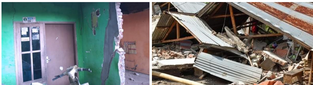
Gambar 3.2 Data Gambar Kerusakan Bangunan
