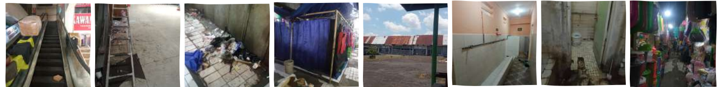
Eskalator rusak yang dijadikan tempat menaruh barang Lantai becek akibat kebocoran atap Sampah pada salah satu lorong pasar Ruang sholat lt.2 yang berada di tengah ruang dan hanya berdinding tirai Lantai 3 yang tidak terpakai dan dijadikan tempat berkumpul oleh anak-anak remaja WC mushola lt.3 yang hanya memiliki ketinggian dinding 150 cm Kondisi WC di lt.2 pasar yang kurang bersih dan beberapa bagian rusak Lorong antar retail yang dipersempit oleh beberapa barang jualan
