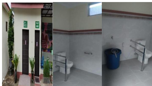
Toilet Khusus Difabel
