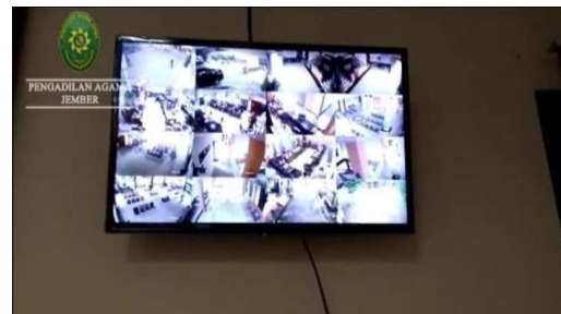
Ruang kontrol CCTV
