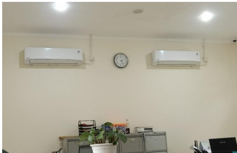
Gambar 4. 17 : Air Conditioner di Ruang Penyimpanan Arsip Aktif (Sumber : Dokumentasi Peneliti, 2022)
