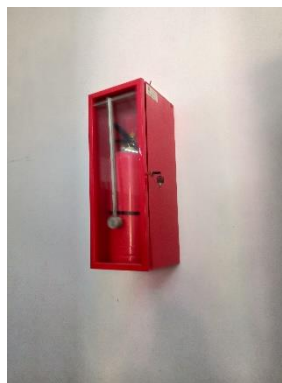
Gambar 4.8 Alat Pemadam Kebakaran (Sumber: Dokumen Peneliti, 2023)
