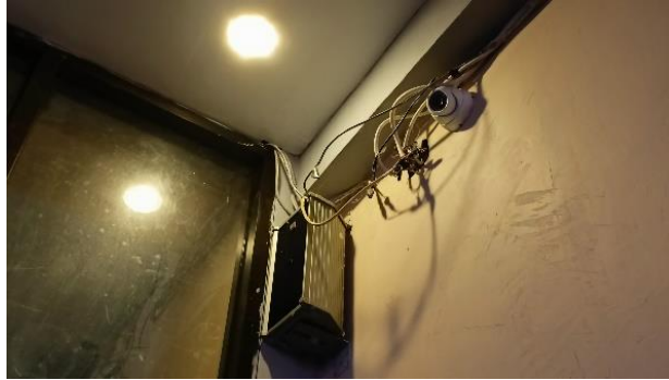
Gambar 4. 1 sarana prasarana yang perlu perbaikan dan penataan
