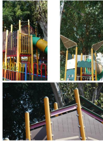
Gambar 4.6 : Area Bermain Tidak Ada Atap
