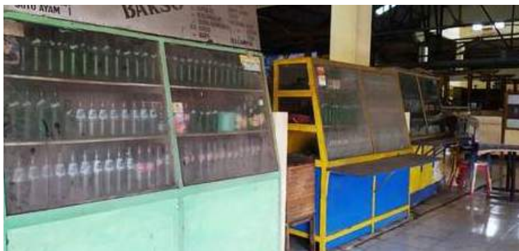
Gambar 1.6 Lantai 2 Pasar Legi yang Terbengkalai
