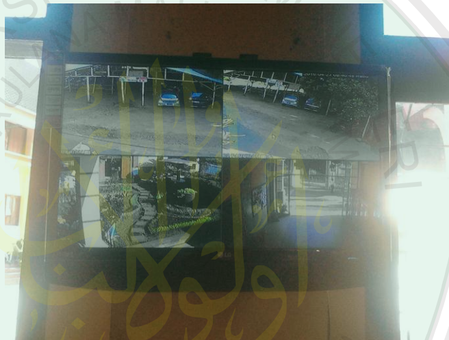
Gambar 4.5 : Monitor kamera CCTV di ruang Tata Usaha (Sumber : Dokumentasi peneliti di MAN Batu) 151
