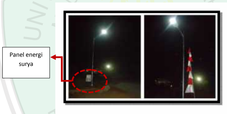
Gambar 2.67. lampu jalan dengan energi matahari
