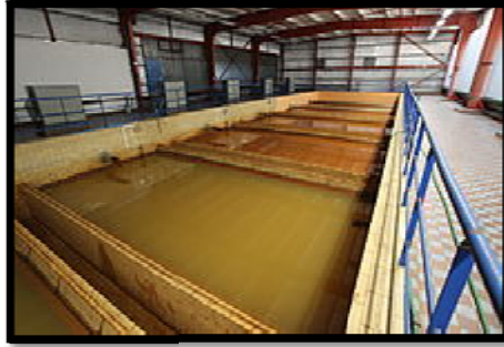
Gambar 2.37 Area Endapan pada WWTP
