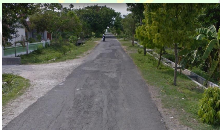
Gambar 2.6 Foto Jalan Aspal yang memerlukan Perbaikan di Desa Cengkir Kecamatan Kepohbaru diambil pada tanggal 20 Oktober 2020
