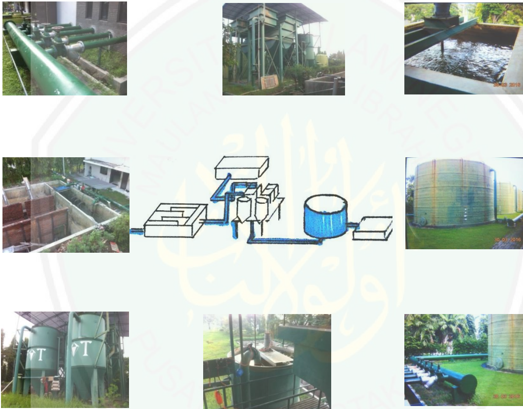
Gambar 5.13. Sistem Water Treatment Sumber : Dokumentasi Pribadi, 2016
