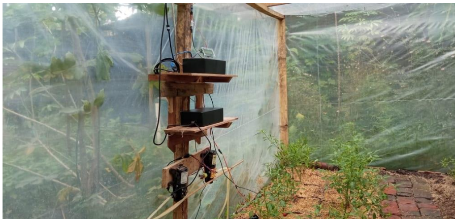
Gambar 4. 12 Penempatan Hardware pada greenhouse
