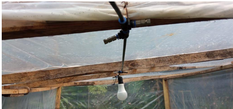
Gambar 4. 13 Instalasi Pengkabutan Otomatis
