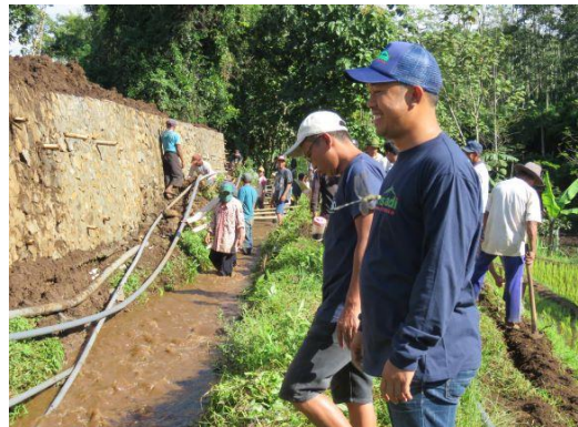
Kegiatan pasang pipa air Warga Kegiatan Sosial Pemasangan ulang pipa air warga bersama koramil Karnagploso
