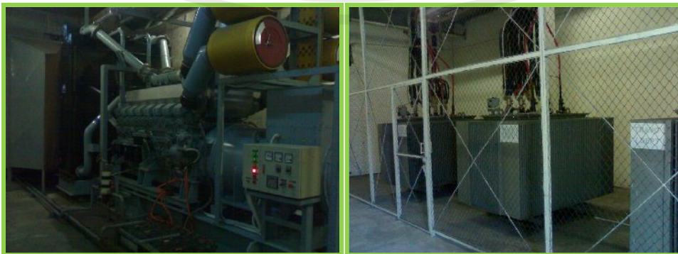
Gbr 4.82. Genset dan trafo Sumber: Dokumentasi pribadi (2010)
