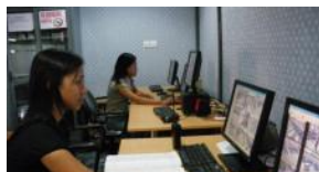
Gambar 2.50 Ruang Kendali CCTV (Sumber: Google.com, 2013)
