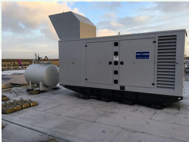
Gambar 2.8 Generator Cadangan Listrik Bandara
