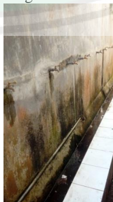
Gambar 1.9 tempat wudhu sebelah kamar mandi yang kurang terawat
