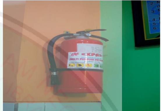
Sistem proteksi kebakaran (APAR)
