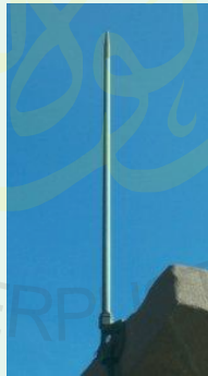
Gambar 4.68: Alat penangkal petir (Sumber: kuliah utilitas, 2013)
