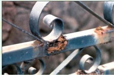
Gambar 4.5 korosi (Sumber: Dokumentasi, 2012)
