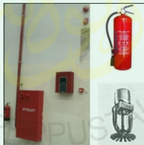
Gambar : 4.34 Haydrant, PAR & Splinkler Sumber : Hasil analisis. 2013
